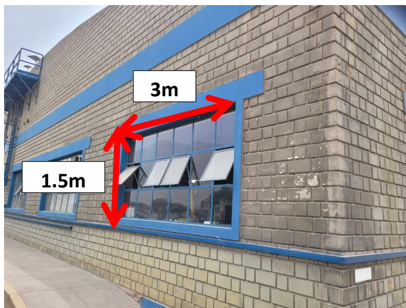
IMAGEN 2. Arreglo de ventanas N°02 a cambiar, acá no hay rejas.
